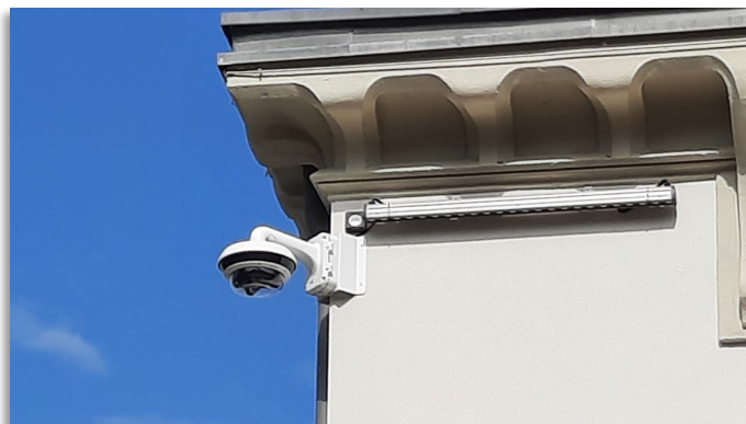
Caméra de vidéoprotection installée place de la mairie
