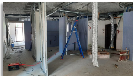
Plomberie et électricité dans la cuisine
