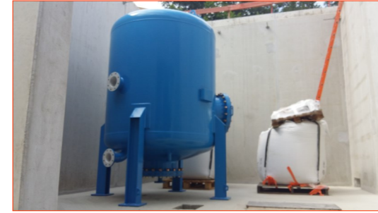
5 juillet 2016 - Filtre à sable de Bellecombe
