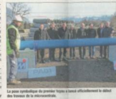
La pose symbolique du premier tuyau à bord officiellement le début des travaux de la microcentrale.
